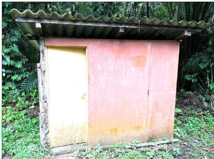
Ilustración 8. Cuarto Transformador. Fuente: Consultor IMAC de Colombia SAS
