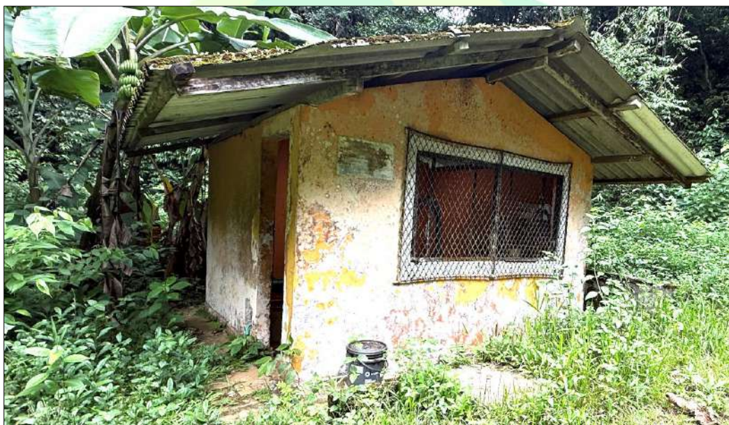
Ilustración 2. Casa Maquinas PCH. Fuente: Consultor IMAC de Colombia SAS
