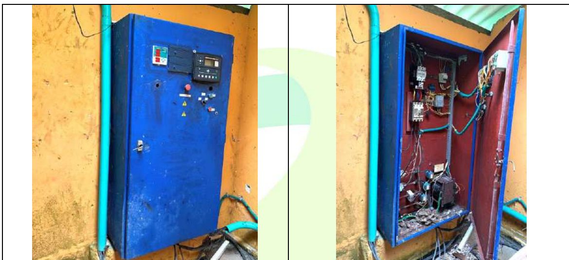
Ilustración 5. Tablero Control PCH 440V. Fuente: Consultor IMAC de Colombia SAS
