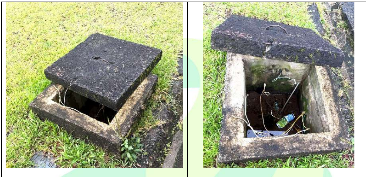
Ilustración 11. Sistema de Distribución Cajas de Piso. Fuente: Consultor IMAC de Colombia SAS
