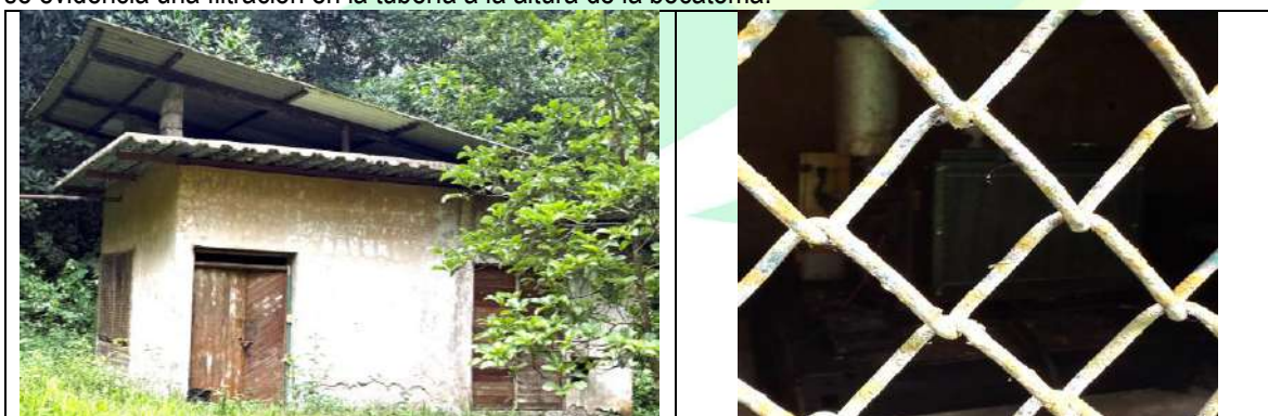
Ilustración 7. Casa de Maquinas Generador Diesel 40kVA. Fuente: Consultor IMAC de Colombia SAS
