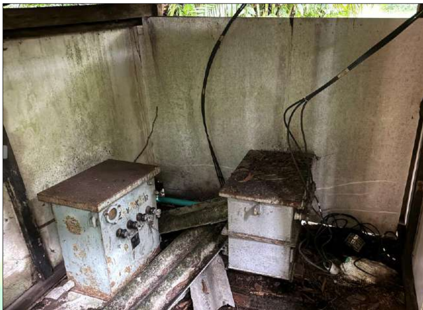
Ilustración 9. Transformador 20kVA. Fuente: Consultor IMAC de Colombia SAS
