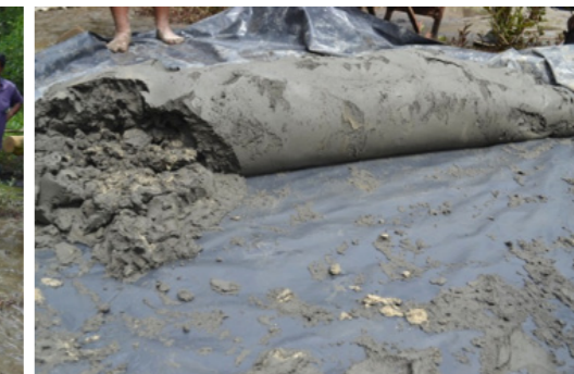
18 Masa formada de barro, arena y cemento después de mover el plástico
