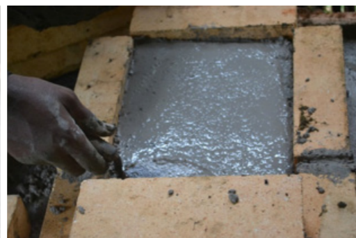
35 Capa de cemento refractario que cubre la capa de arena, barro o ceniza vertida anteriormente
