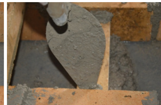
33 Pegado con cemento refractario del ladrillo de barrera de la segunda hornilla
