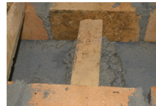
32 Ubicación del ladrillo de barrera de la segunda hornilla
