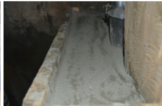
67 Detalle del bloque de cemento refractario
